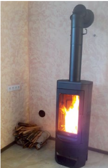
Endlich eine Heizung für das Kulturhaus in Seimeny
