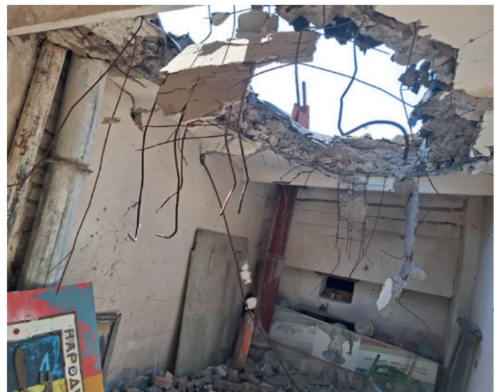
Raketeneinschlag im Dach einer Sporthalle
