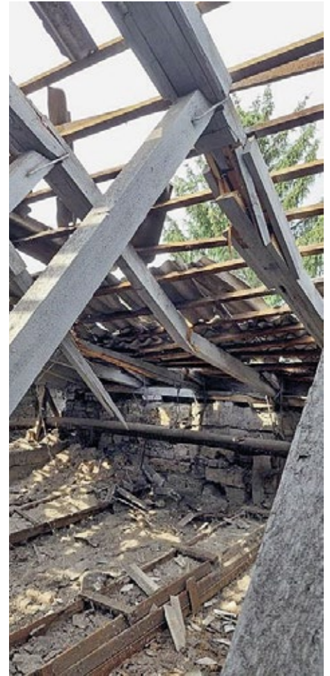
Das Dach eines Lehrgebäudes wurde fast vollständig zerstört alle weiteren Fotos: Ukrainisch-Deutsche Fakultät der NUOP
