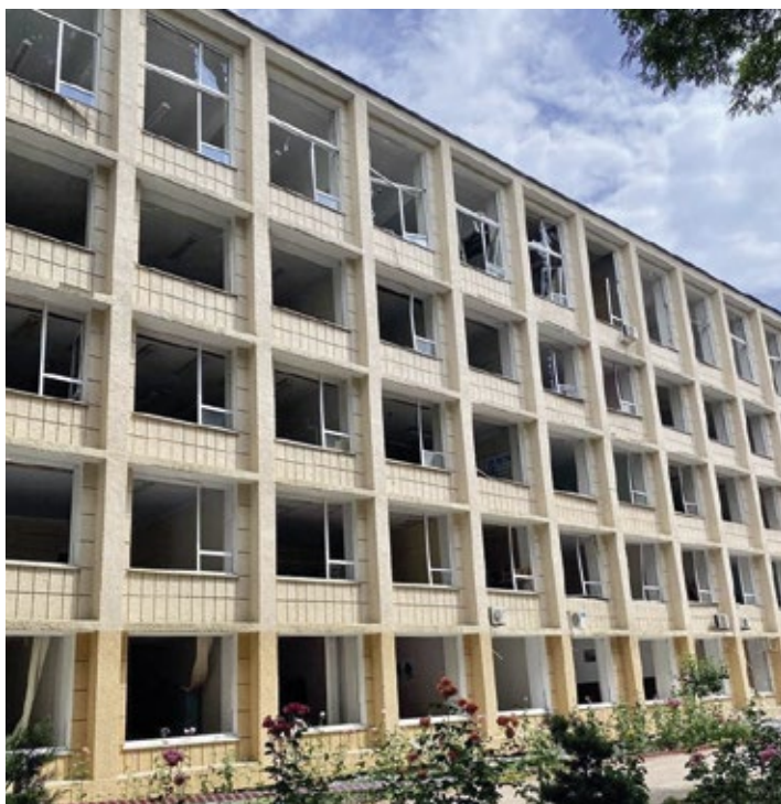
Fast alle Fenster des Hauptgebäudes sind nun zerstört
