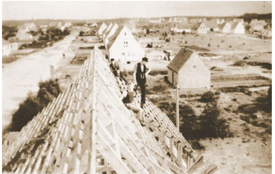
Die Königsberger Straße der Heidesiedlung in Neu Wulmstorf 1953. Der Siedler Herr Bredehöft auf dem Dachstuhl seines neu errichteten Hauses. Der heute 91-jährige Herr Bredehöft und seine Ehefrau wohnen noch immer in ihrem selbsterbauten Siedlungsbaus.
